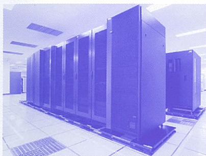
図2 データセンターでの使用例
